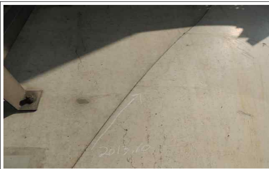
교각 P4 코핑부 경사균열(CW=0.1mm)
