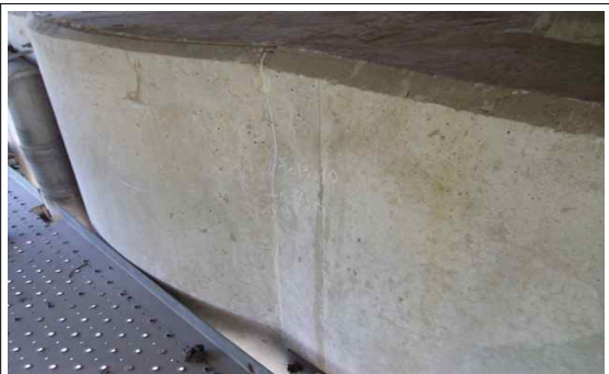
교각 하행선 P2 코핑부 수직균열(CW=0.2mm)
