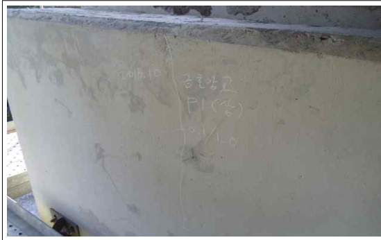
교각 상행선 P1 코핑부 수직균열(CW=0.1mm)
