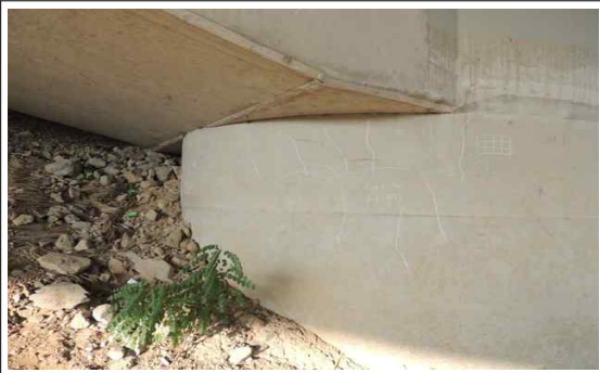
교각 시내방향 P3 기둥부 망상균열
