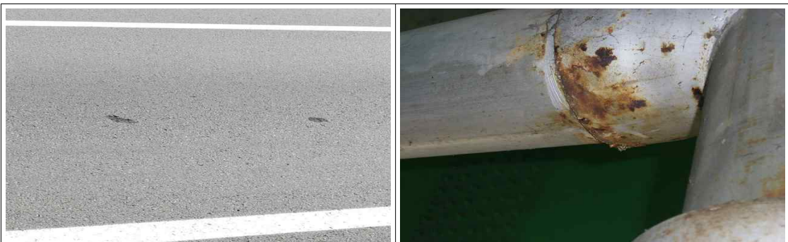
교면포장 하행선 S6 패임
