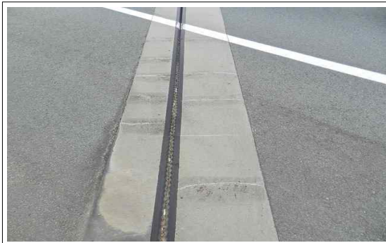
신축이음 상행선 Exp.J2(A2) 후타재 균열 (CW=0.2mm)
