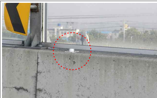
부대시설 방호벽 S2 델리네이터 파손
