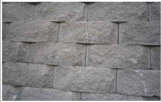
보강토옹벽 S6 균열 (폭 1.0mm)
