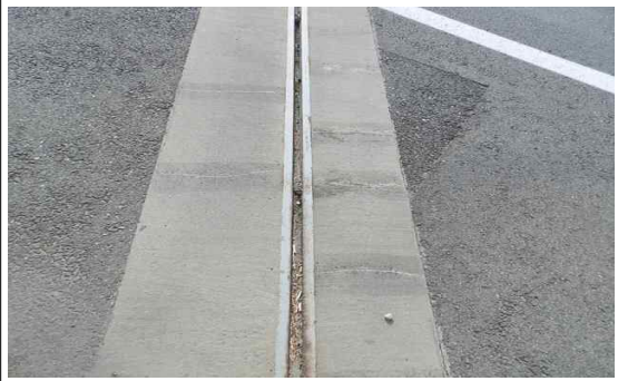
신축이음 상행선 Exp.J1(A1) 후타재 균열 (CW=0.2mm)
