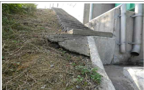
부대시설 상행선 A1 점검계단 하부 토사침하
