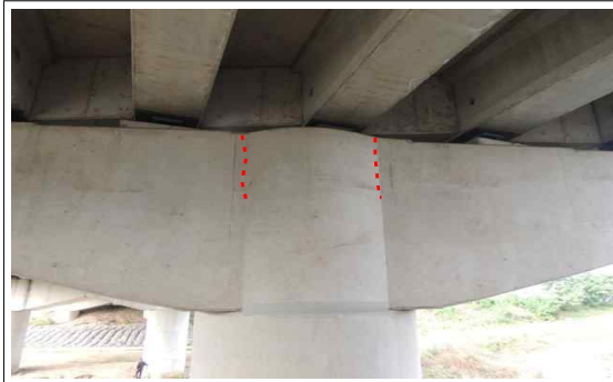
교각 시내방향 P1 코핑부 수직균열 (CW=0.1mm)
