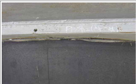
교량받침 하행선 P13 SH2 상부 고무재 들뜸
