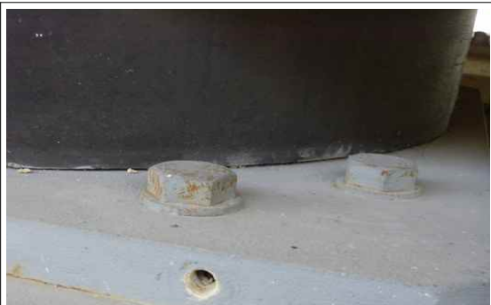
교량받침 하행선 P8 SH1 하부 고무재 들뜸
