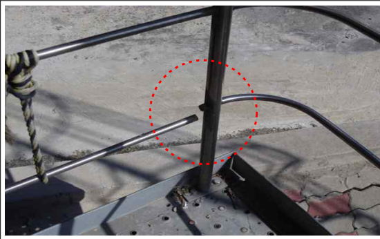
부대시설 상행선 P4 점검로 난간파손
