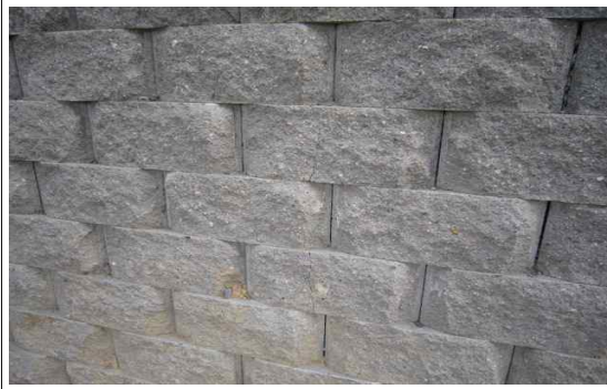
보강토옹벽 S4 균열 (폭 0.5mm)
