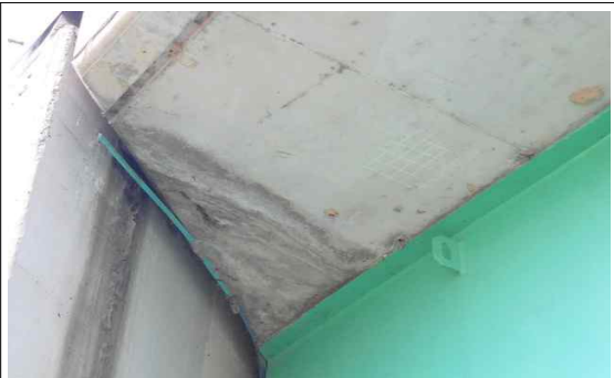
바닥판하면 하행선 S3 캔틸레버 백태
