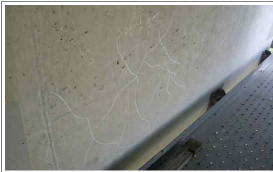
교각 하행선 P1 코핑부 망상균열
