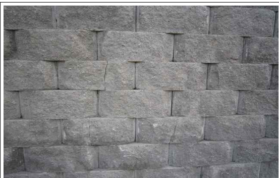
보강토옹벽 S7 균열 (폭 1.0mm, 15EA)
