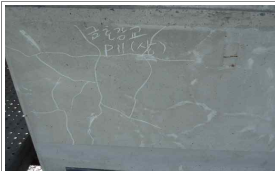
교각 상행선 P11 코핑부 망상균열
