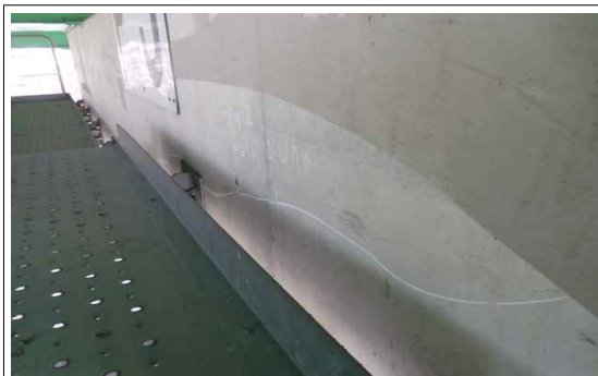
교각 하행선 P3 코핑부 수평균열(CW=0.2mm)
