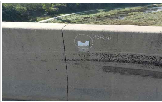
부대시설 하행선 방호벽 S11 텔리네이터 파손
