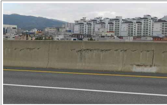
중분대 하행선 S3 균열부 백태
