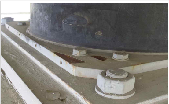
교량받침 하행선 P11 SH2 하부 플레이트 녹발생
