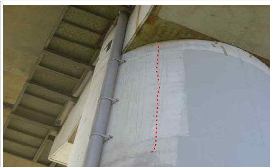
교각 상행선 P16 기둥부 수직균열(CW=0.1mm)
