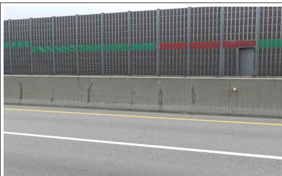
중분대 하행선 S1 균열부 백태
