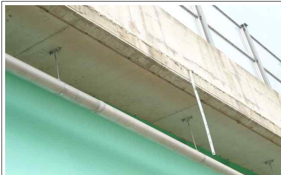
바닥판하면 하행선 S1 캔틸레버 백태
