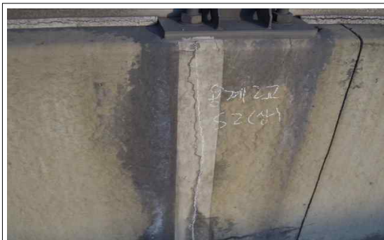
방호벽 상행선 S2 보수부 재균열 (CW=0.2mm)
