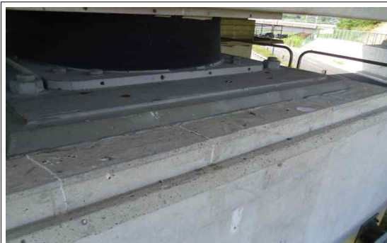
교량받침 상행선 P16 SH1 받침콘크리트 균열 (CW=0.1mm)
