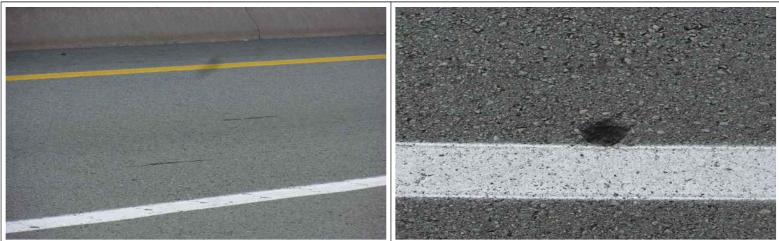
교면포장 상행선 S3 패임
