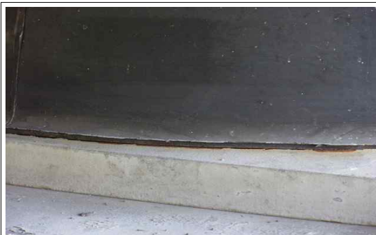
교량받침 하행선 P13 SH1 하부 고무재 들뜸
