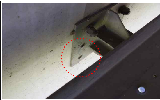
부대시설 상행선 P15 점검로 고정볼트 탈락
