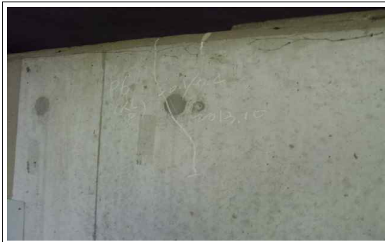
교각 상행선 P6 코핑부 수직균열(CW=0.1mm)
