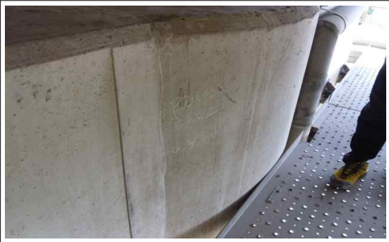
교각 상행선 P3 코핑부 수직균열(CW=0.2mm)
