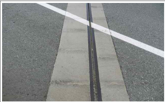
신축이음 하행선 Exp.J2(A2) 후타재 균열 (CW=0.2mm)
