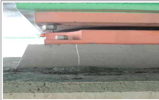
교량받침 P5-SH2 무수축물탈 균열 (CW=0.1mm)
