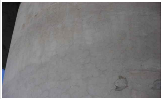
교각 하행선 P3 기둥부 망상균열
