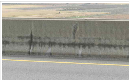
중분대 하행선 S6 균열부 백태
