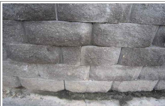
보강토옹벽 S7 균열 (폭 0.5mm)
