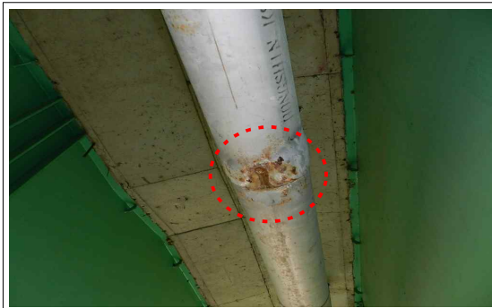
배수시설 하행선 S6 배수관 이음부 누수
