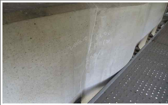
교각 하행선 P11 코핑부 수직균열(CW=0.2mm)
