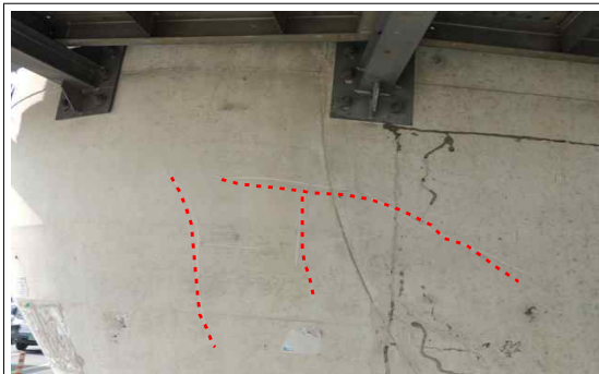
교각 P5 코핑부 수직,수평균열(CW=0.1mm)
