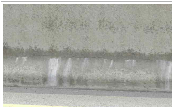
중분대 하행선 S4 균열부 백태
