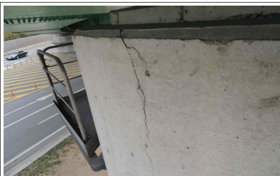
교각 P1 코핑부 수직균열(CW=0.3mm)
