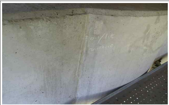
교각 상행선 P8 코핑부 수직균열(CW=0.1mm)
