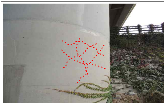
교각 본선방향 P1 기둥부 망상균열
