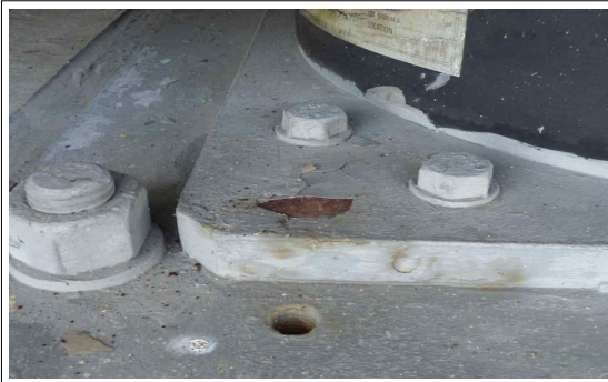
교량받침 상행선 P8 SH2 하부 플레이트 녹발생
