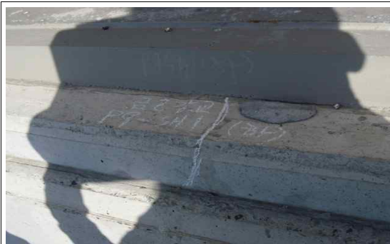
교량받침 하행선 P9 SH1 받침콘크리트 균열 (CW=0.1mm)
