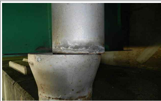
배수시설 하행선 A2 배수관 설치위치 불량
