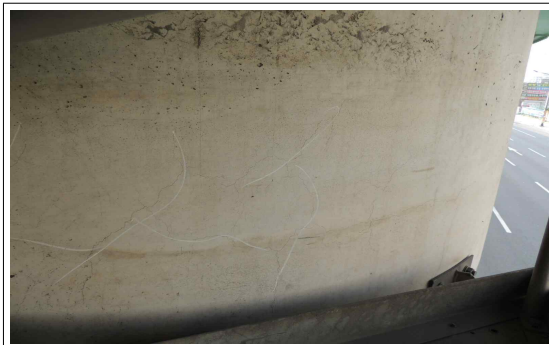
교각 P3 코핑부 망상균열
