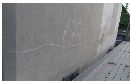
교각 하행선 P5 코핑부 수평균열(CW=0.2mm)
